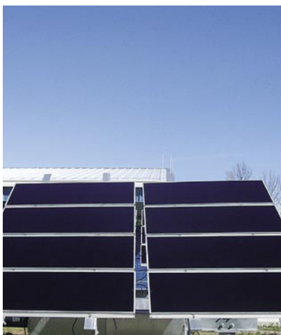
foto: Energibanken AB
