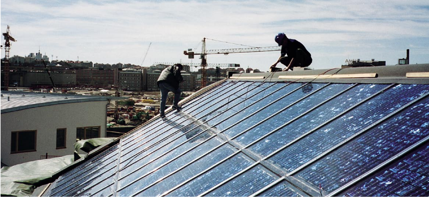
foto: Energibanken AB
